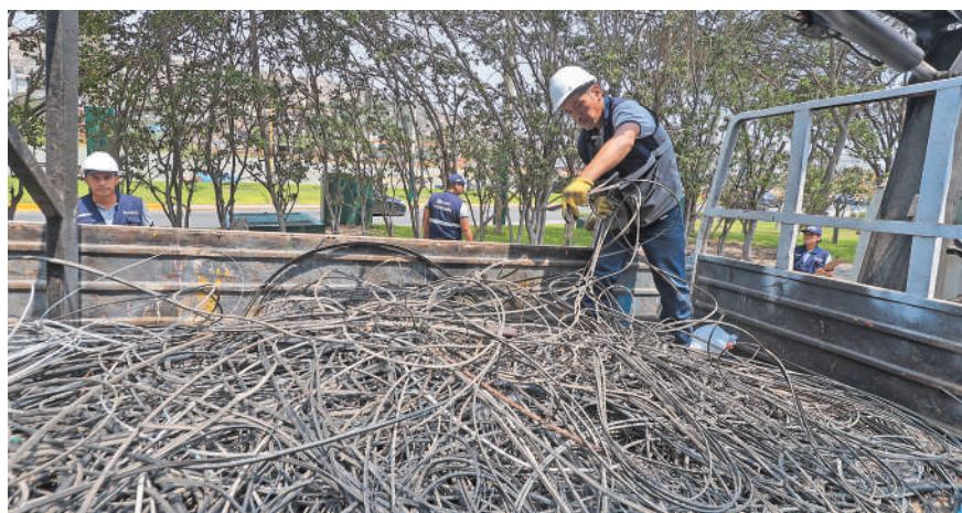
Los cables en desuso o mal instalados son un peligro que afecta cotidianamente a nuestros vecinos.
